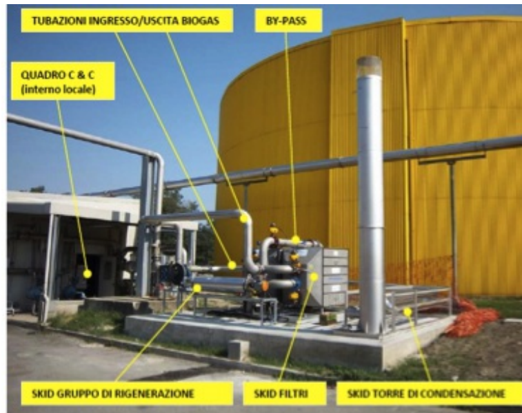
Figura 2 – Sistema di rimozione dei silossani
